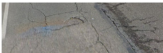
Figura 7. Fenda detectada e provocada por una tapa de sumidoiro.
