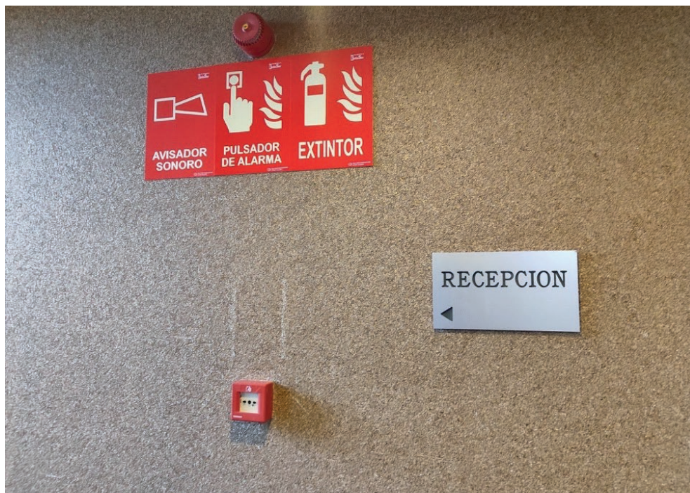
Figura 5. Sinalización no caso de emerxencias no Hotel OCA Vila de Allariz
